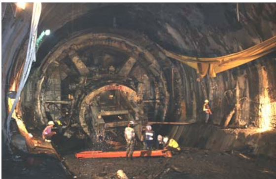
圖三 雪山隧道西行線 TBM38K+902.5 災變清理至機頭 (張文城提供)
