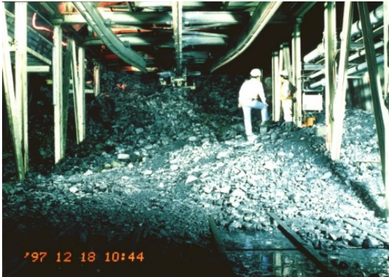
圖二 雪山隧道主坑西行線 38k+902 坍方 (張文城提供)
