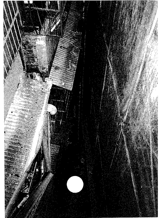
照片二十二 重新貴族(右)與中正南路 8 巷 10 號間之窄巷，白點處為包商正在施作高壓灌漿。此部位應為連續壁破裂處
