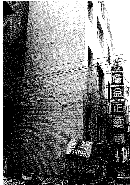
照片十三 重新路三段 60 巷 1 號塌落撞擊引致二樓頂之水平裂縫
