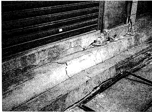
照片十九 中正南路 8 巷 4 號門前石階折裂及路面裂縫(鋁窗框處)
