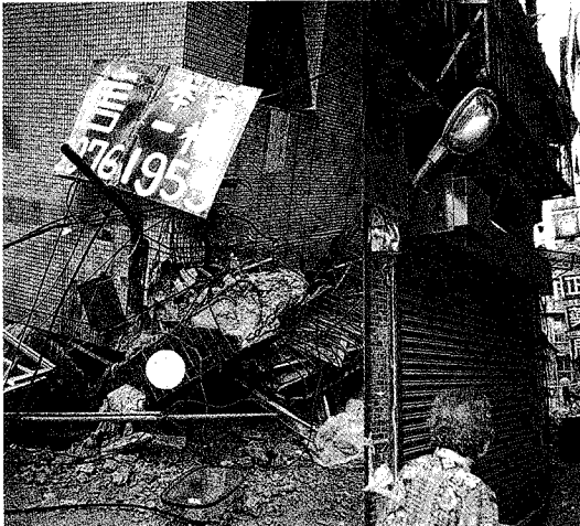
照片十一 重新路三段 60 巷 1 號之 1 樓之斷柱(白點)，其旁之路燈原固定在一樓頂(如右圖)高度
