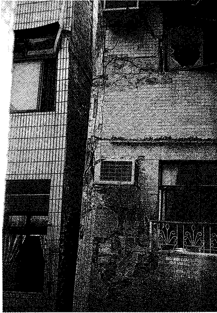
照片六 中正南路 8 巷 10 號下陷後結構弱點 剪力破壞
