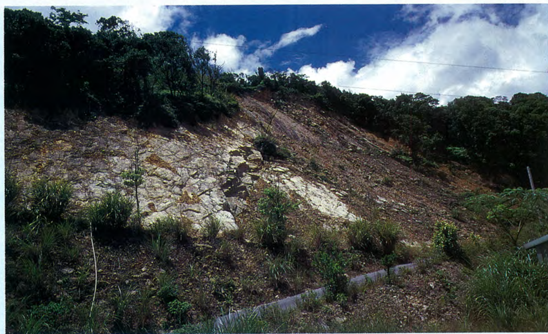
照片二十二 高度破碎與不穩之順向坡，八連路北側某一步道邊
