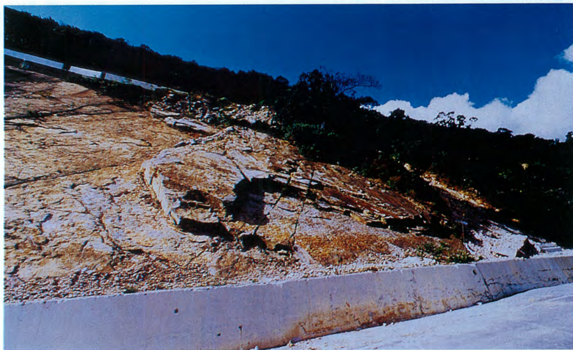
照片二十 照片十九順向坡面上暫停之岩板
