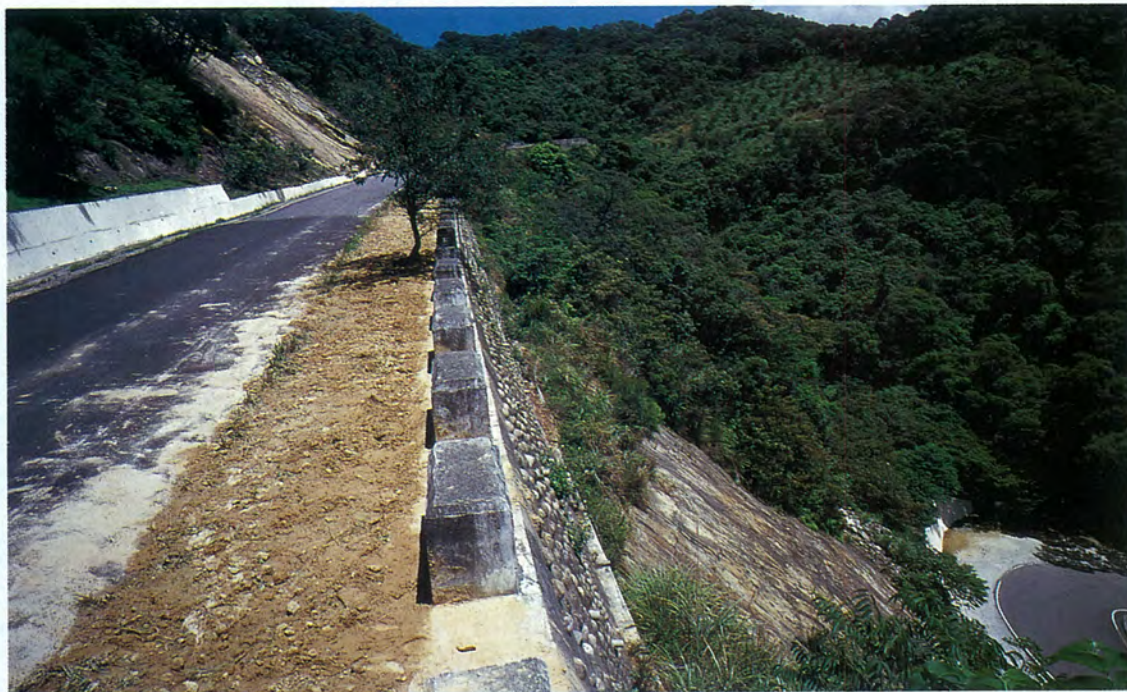
照片二十一 公路上、下邊坡皆為順向坡之景觀
