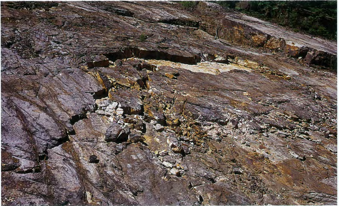
照片十五 照片十順向坡面上岩層開裂且部分脫皮的現象
