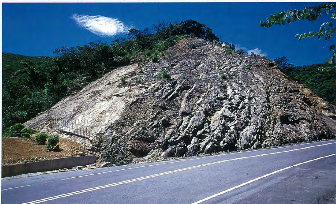
照片八 汐萬路四號橋處小規模單面山之東南坡呈現順向坡與順向坡滑動現象
