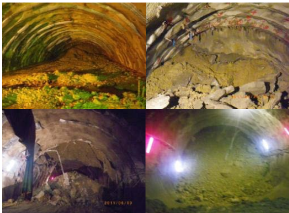
圖十七 山里隧道上半斷面開挖遭遇抽坍
