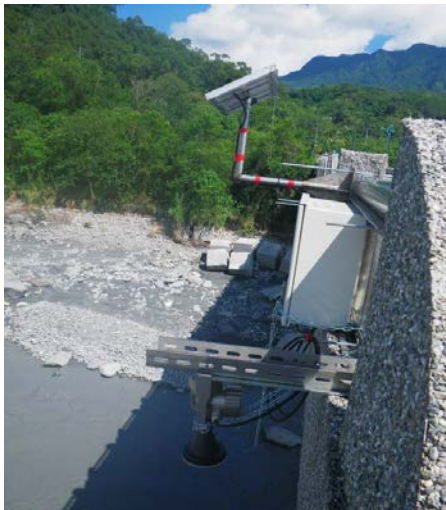
圖十一 鸞山大橋自動水位監測系統
