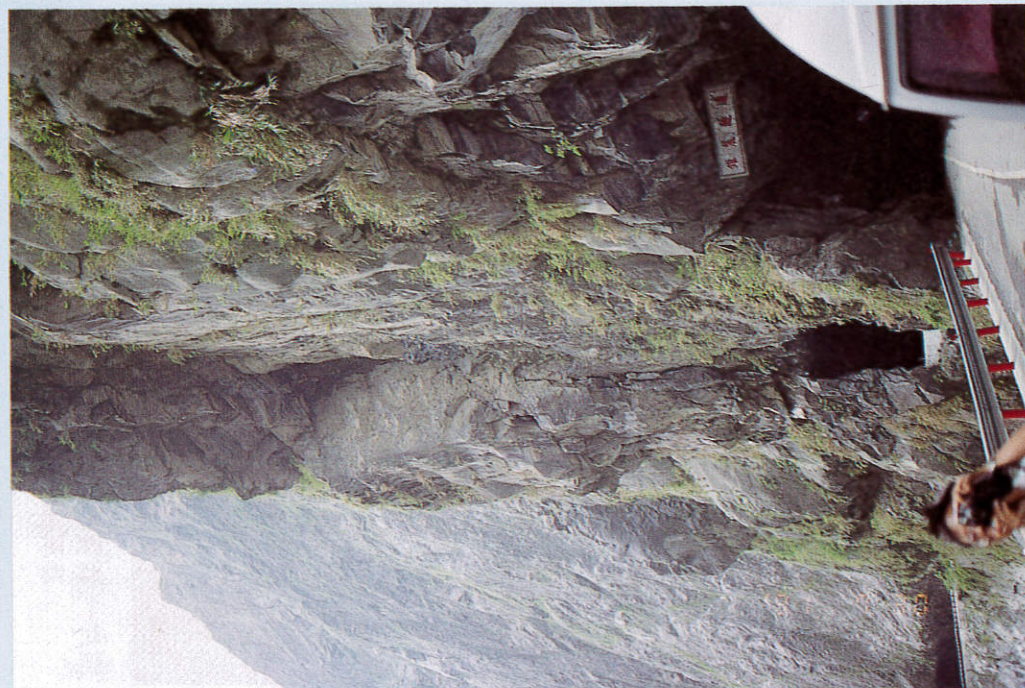
照片三 錐鹿隧道 (台八線 177.5K) 外側峭壁之解壓節理 ( 1/4 )
