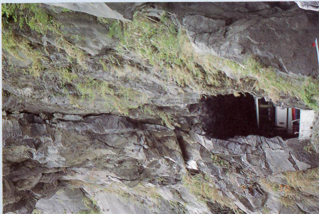
照片四 錐鹿隧道 (台八線 177.5K) 外側峭壁之解壓節理 ( 2/4 )
