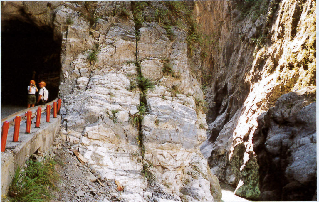
照片十一 接近谷底處谷岸解壓節理之例
