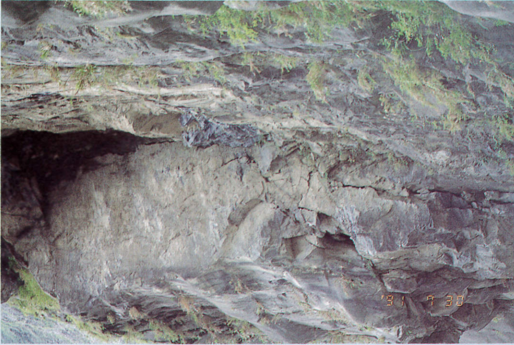
照片六 錐鹿隧道 (台八線 177.5K) 外側峭壁之解壓節理 ( 4/4 )
