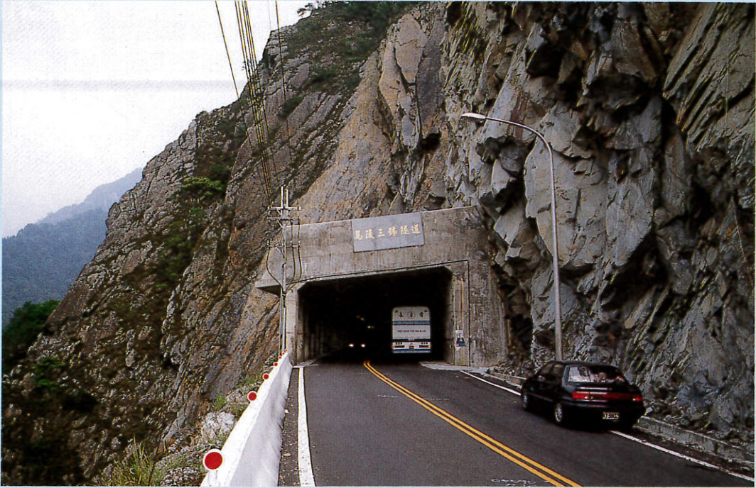
照片九 馬陵三號隧道東口之解壓節理，全景
