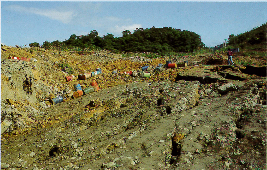
照片九 政大原環山道路低線路段在地滑區西界附近發生斷崖之情形(80. 11. 21 攝)
