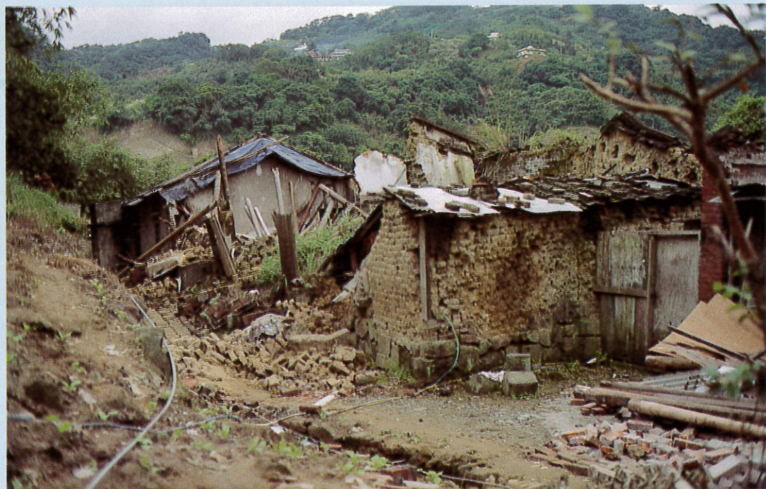
照片八 張宅背後古屋毀損，地坪開裂(80. 11. 17 攝)
