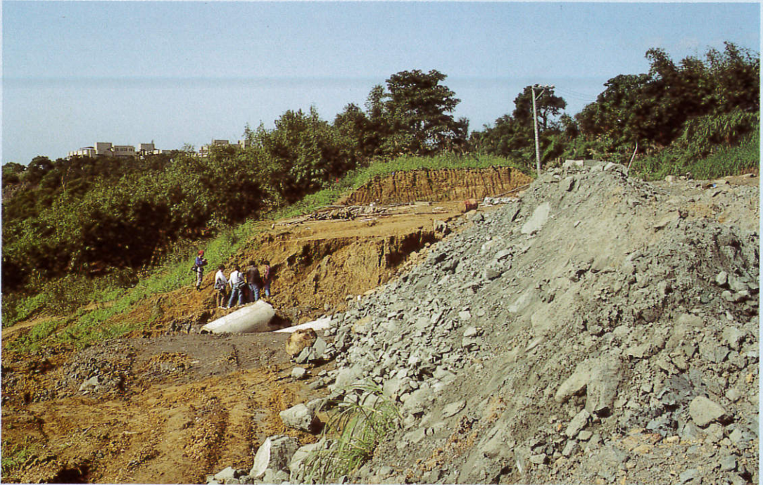
照片十四 地滑區內坡面上之棄方與坍塌情形(80年11月中攝)
