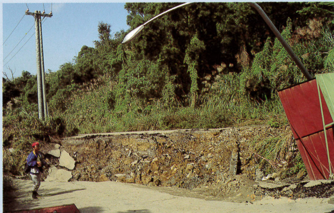
照片九 政大原環山道路低線路段在地滑區西界附近發生斷崖之情形(80. 11. 21 攝)
