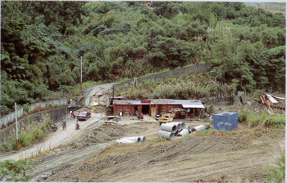
照片六 待老坑北坡趾通往張宅之小橋及道路損壞，車行交通中斷，全景(80. 11. 17 攝)
