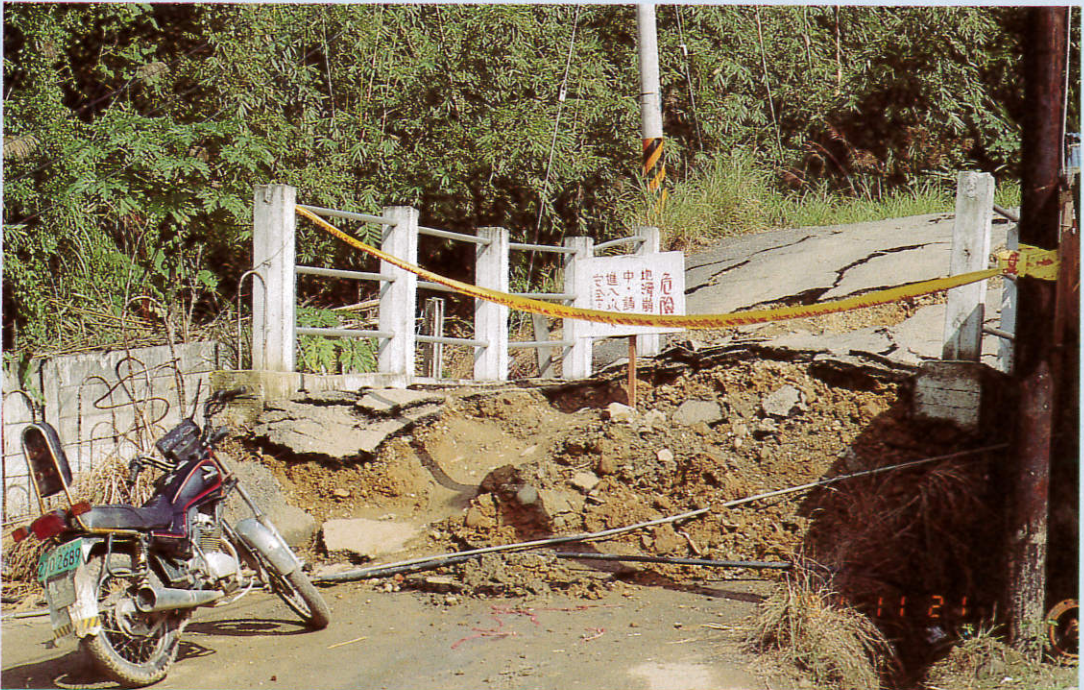
照片七 待老坑北坡趾通往張宅之小橋全毀，近照(80. 11. 21 攝)
