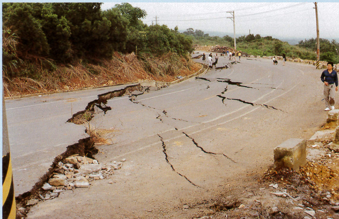
照片八 坡頂道路裂縫
