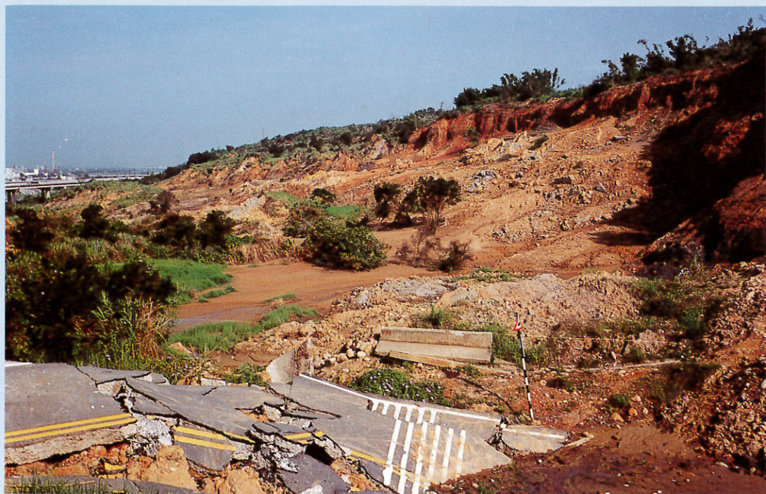
照片三 坍方殘坡之情形 (坍方後約一個月)
