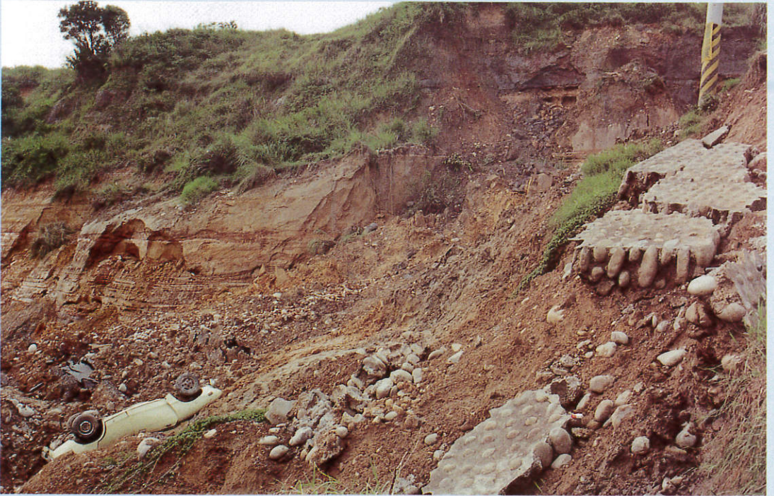
照片六 坍方災害舉例之二，護坡之翻倒及汽車翻覆
