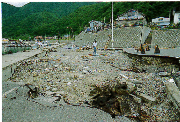
照片七 碼頭及附屬工程之破壞
