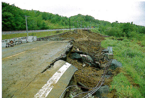
照片九 道路破壞
