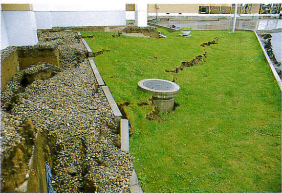
照片五 地裂及地盤陷落
