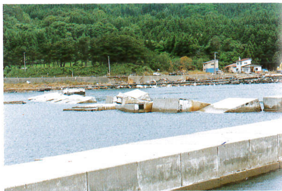
照片八 防波堤破壞
