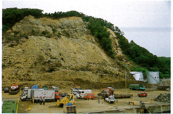
照片二 奧尻港山崩（坍方）災害近照
