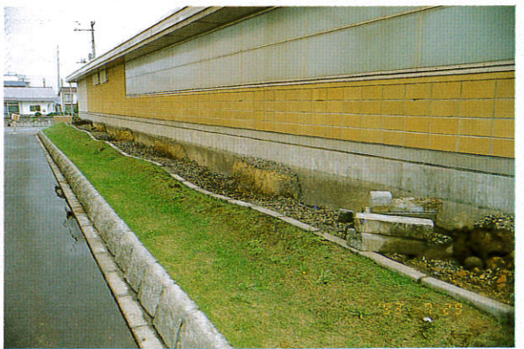
照片六 地盤陷落並發生波浪狀變形
