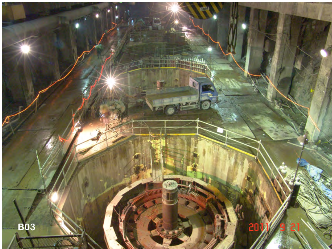
積水抽除清理後，地下電廠之土木結構完整無損，發電機組設備則已損壞無法使用，復建工程中將之拆除重置
