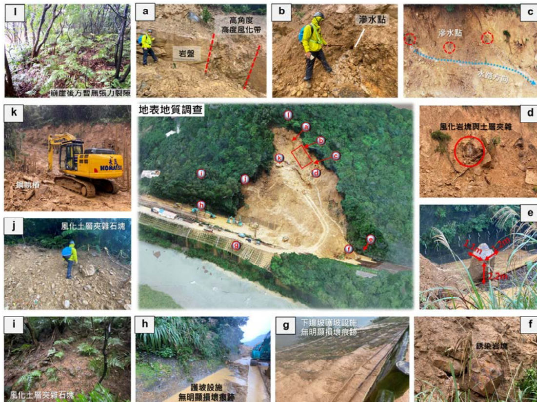
圖八 臺鐵猴硐崩塌現地調查位置
