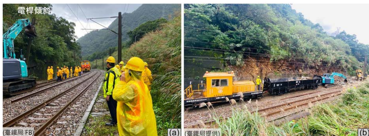
圖一 11月30日臺鐵瑞芳-猴硐區間發生邊坡失穩，電桿傾斜，且可見擋土牆裂縫已有植生
