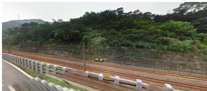
圖七 Google地圖的街景照片顯示老舊擋土牆無排水孔，且有大量水平裂縫，裂隙都已夾雜植生，中央的電桿即為前期事件中傾倒的電桿，街景照片攝於2016年3月
