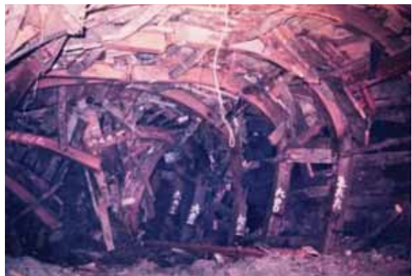
圖二十四 舊自強隧道坍塌照片(東線鐵路拓寬工程處，1985)
