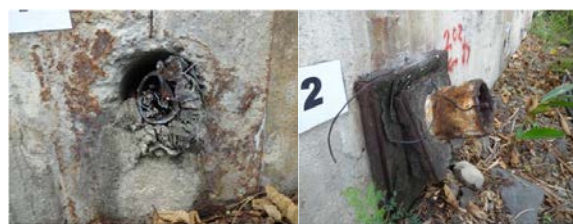
(a) 錨頭掉落
