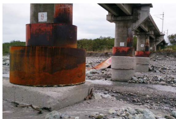
圖四 利嘉溪橋沉箱基礎裸露情形
