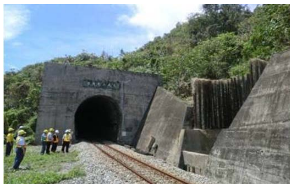
圖十 大武二號隧道北口蝕溝保護設施
