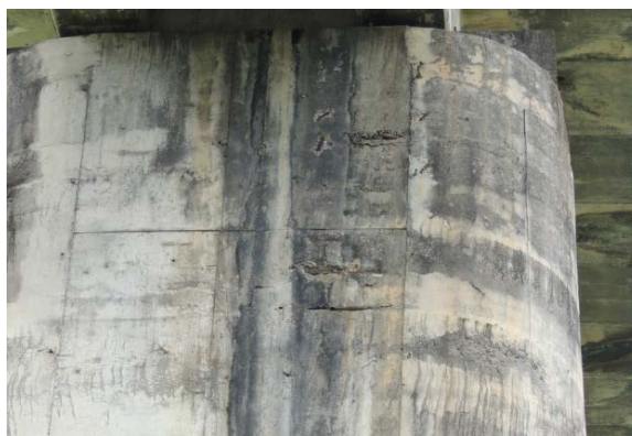
圖三 加津林橋橋墩混凝土剝落及鋼筋銹蝕情形
