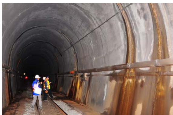
圖六 金崙隧道內滲漏水情形
