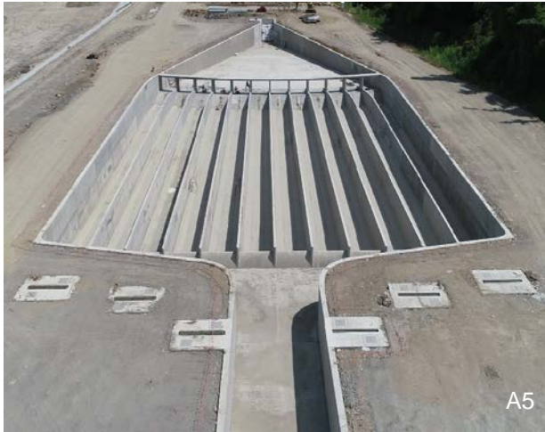
A5 引水設施工程/沉砂池/水流自上方向下方流動，經逆波工分流至 12 道沉砂溝中，進行懸浮固體沉降，沉降目標粒徑為 0.2 毫米，清水過溢流堰後經隧道往湖區輸送，淤砂則自溢流堰下方排回烏溪
