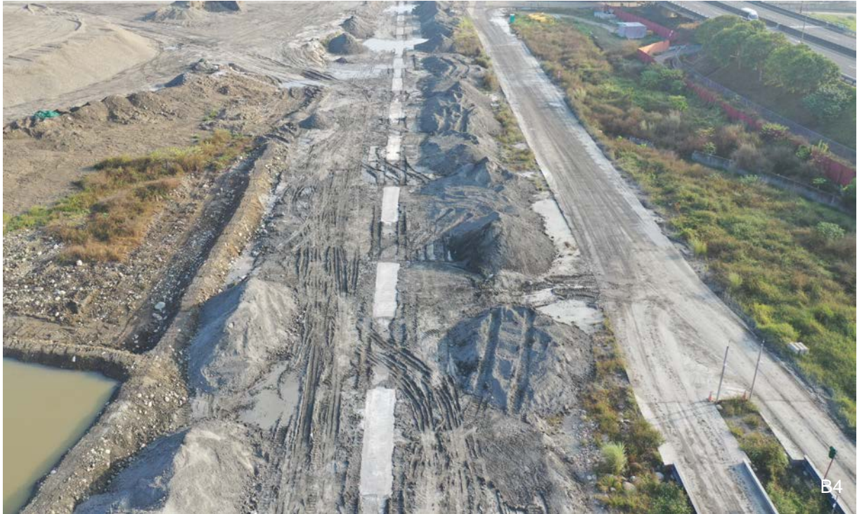
B4 人工湖工程/截水牆/將湖區內之水體與區外之水體區隔，確保湖區內水體不與區外水體接觸，截水牆採連續設置、間格施作，寬度 1m，深度不等，以入岩 2m 為原則
