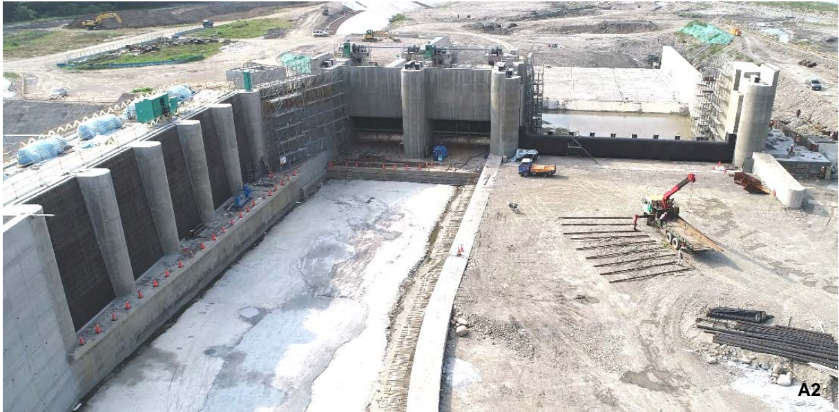
A2 引水設施工程/取水口(40m 寬)及排砂道(60m 寬)/自左向右分別為五道直提式閘門(取水口)、兩道弧形閘門及一道殼型閘門(排砂道)，其中殼型閘門寬度為 30m 為全台最大型閘門，大面寬閘門具減少閘墩之阻水面積、降低門數俾利操作等優勢，更可輔助排洪，因應未來極端氣候條件下所帶來的極端洪水及降低水流過度集中帶來的過度沖刷
