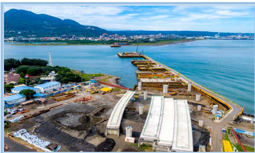
C11 淡水端陸側主橋及匝環道橋面版與墩柱已部分完成，遠方為450M長跨度之八里端橋墩基礎圍堰
