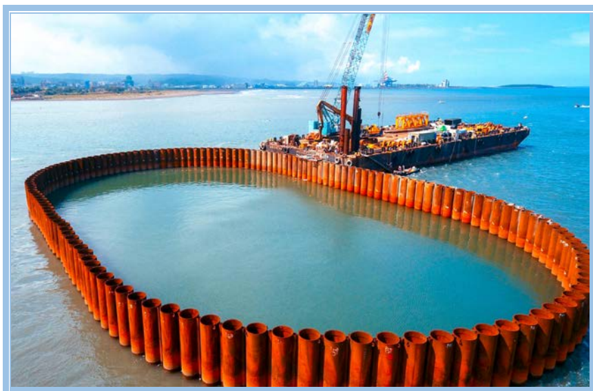
C2 P130主橋塔基礎施工須先打設144支直徑1.2M之鋼管版樁圍堰撐工法採兩階環形支撐
