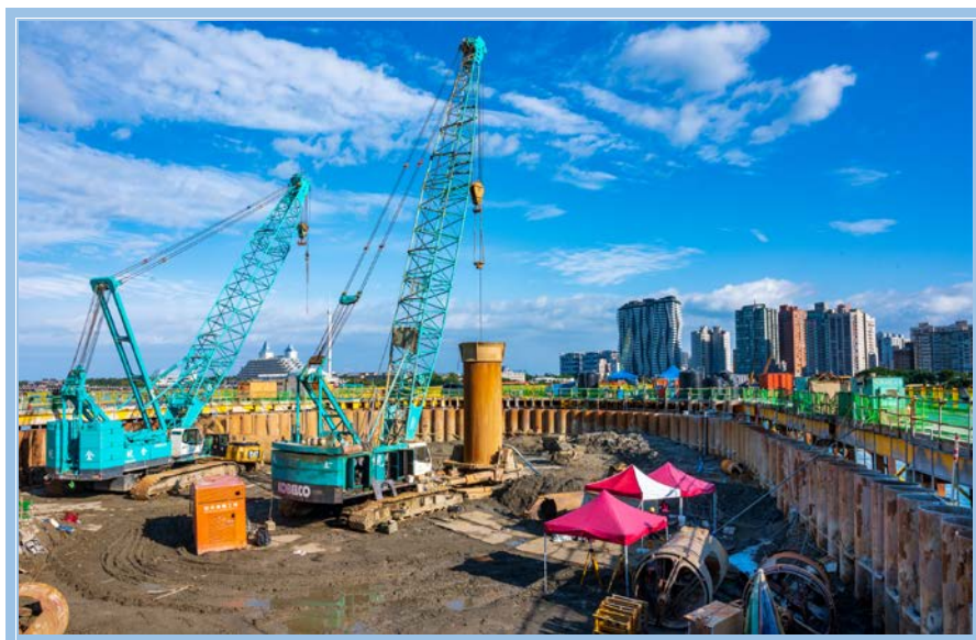
C3 P130主橋塔基礎採用樁徑2.5m，樁長65m之全套管基樁，深入大南灣層，基樁於圍堰內填土施工
