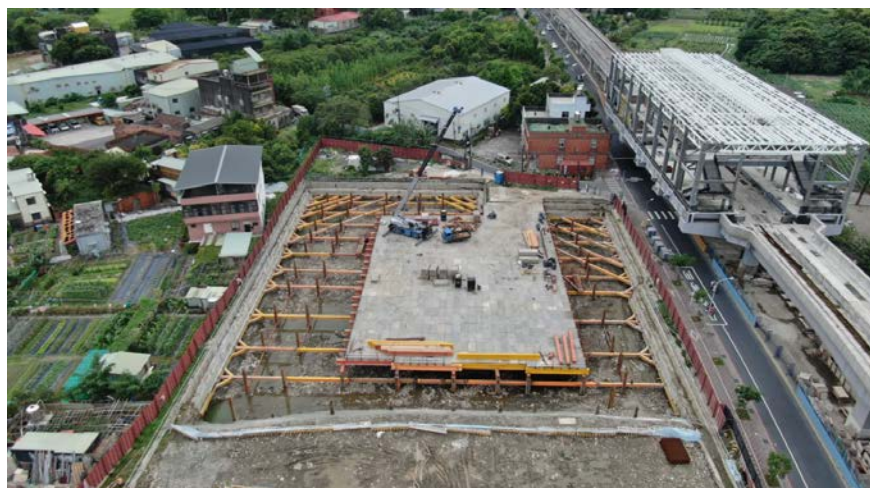
C7 右側為LB05車站，屬於側式月台車站。車站旁同時規劃聯合開發大樓，地下室並兼作捷運設施機房使用，照片中間為聯開大樓地下室開挖支撐現況，預計開挖地下4層，深度約18.2公尺
