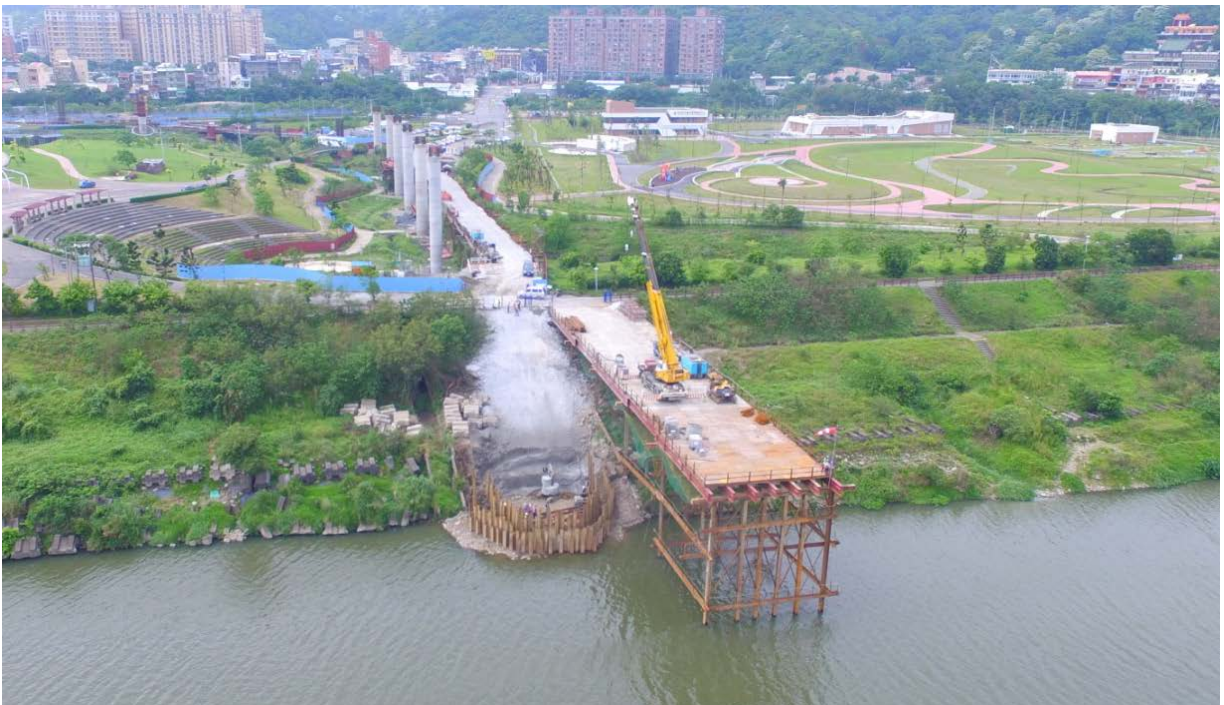
C5 三峽端之現場施工狀況，上方大漢溪對岸為鶯歌端，施工時採用圍堰擋土施工，井基設計深度為31.5公尺深、井基直徑為10.5公尺
