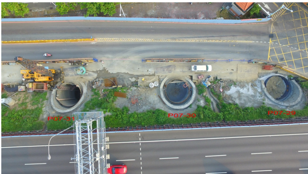
C2 高速公路邊坡上之井式基礎開挖支撐採用「竹削工法」，配合錨栓及掛網噴凝土施作穩定國道三號既有邊坡，維護高速公路行車安全
