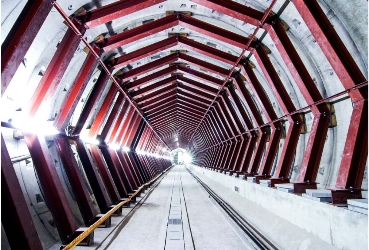
C5 兩隧道淨間距小於 1 倍隧道直徑時，後挖隧道施工時將影響既有隧道，故以八角形內支撐進行既有隧道保護
