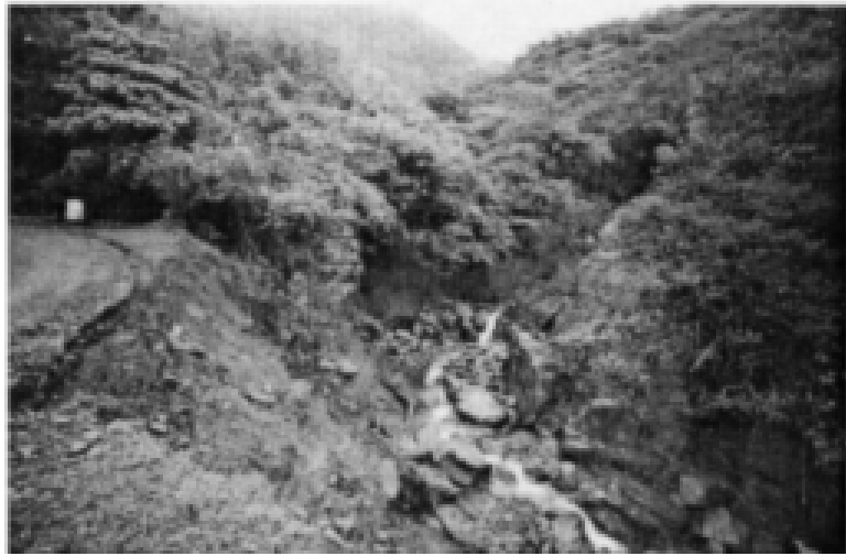
圖七 土石流流動段(輸送帶)之刷深與刷寬現象(台灣東北部)
