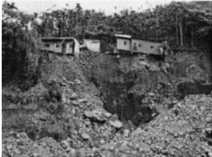
圖十 水里鄉新山村平坑被土石流刷深、刷寬之情形
