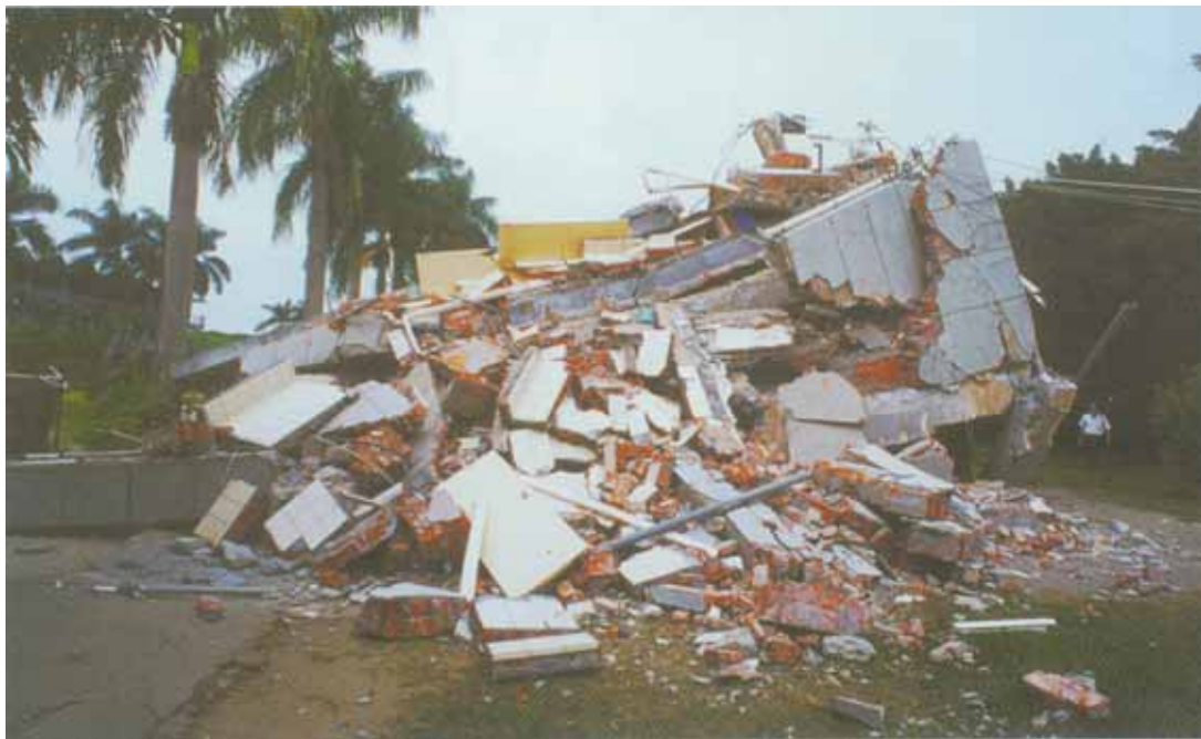
照片十四 光復國中校舍北棟建築東端倒塌的情形
