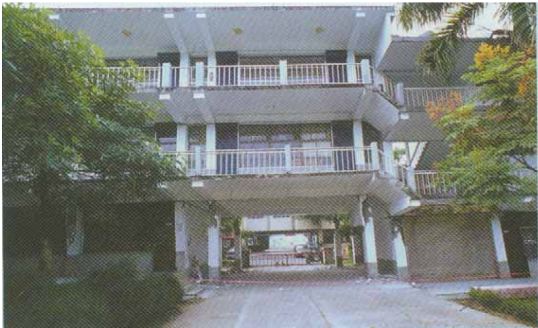
照片十 光復國中校舍南棟建築，位於斷層下盤，損傷但未倒塌
