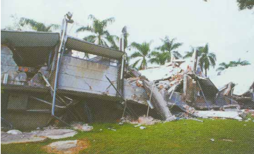
照片十三 光復國中校舍北棟建築中央部分被斷層切過而倒塌的近照
