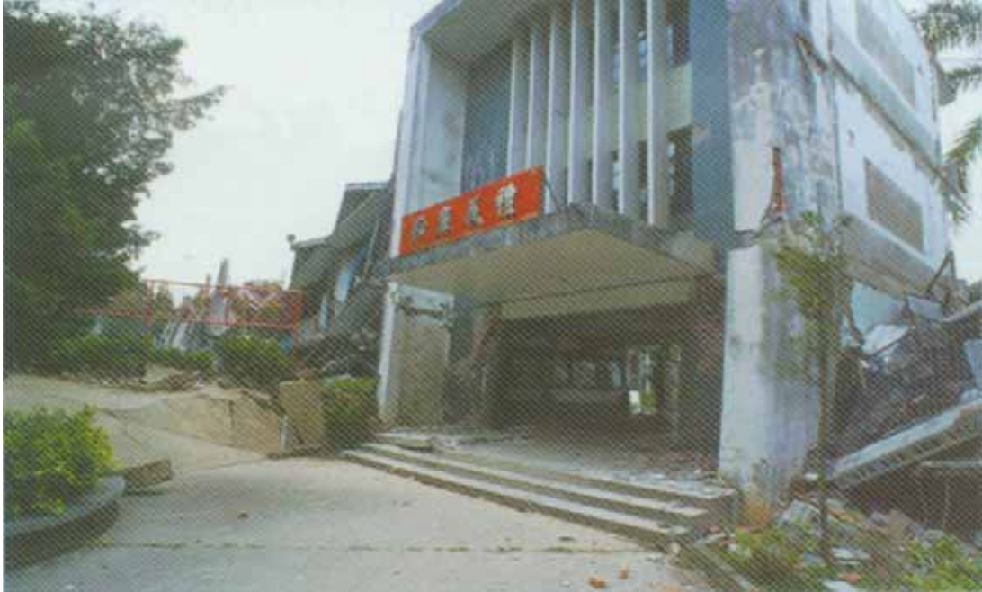
照片十七 逆斷層逼近光復國中校舍北棟建築中央通道的情形
