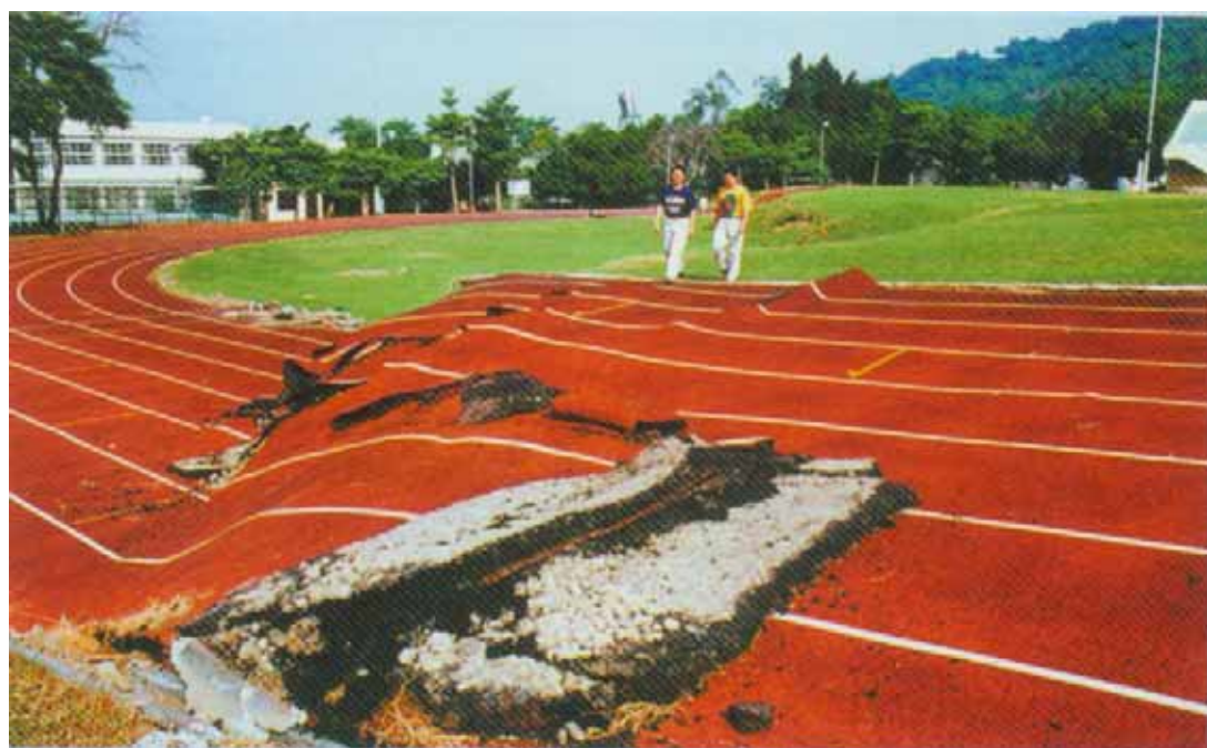
照片四 在光復國中操場南跑道之處，由斷層上盤俯視下盤
