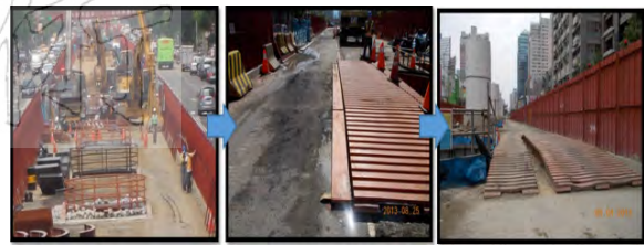
1. 動線空間不足施 2. 拆除部分景基護 3. 恢復護欄，施工 工機具通行 欄，放置棧橋 機具順利通行
