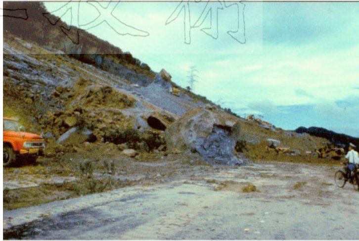
照片三 民國66年9月一場豪雨造成中山高速公路北側順向坡滑動，公路交通中斷數日(洪如江攝)
