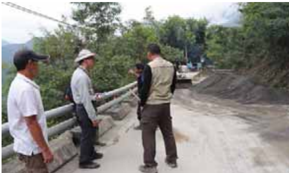
圖二十五 台23線道路中斷施工情形 (丁禕攝, 2017/10/22)
