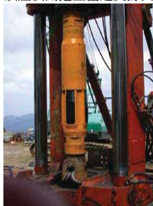
投影片 15 雪山隧道 1 號豎井(500m)以導向鑽孔系統進行昇鑽工法
