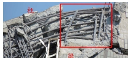
圖六 維冠金龍大樓現場梁柱接頭無箍筋
