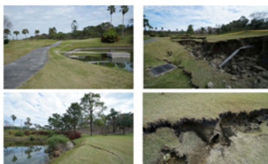
圖十 南寶高爾夫球場現場邊坡破壞照片
