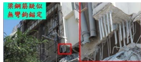
圖八 維冠金龍大樓現場梁筋疑似無彎鉤
