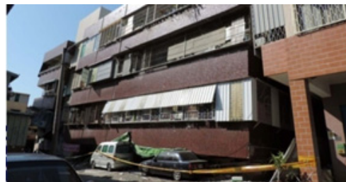
圖五 長東街 103 巷市場損壞
