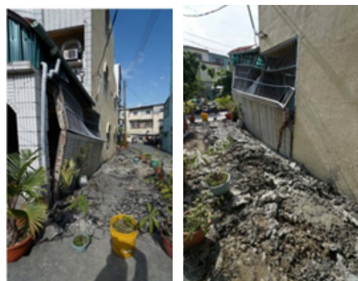
圖十一 新市區三民街土壤液化照片
