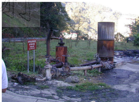
照片三 NL-2 地熱井及井口裝置
