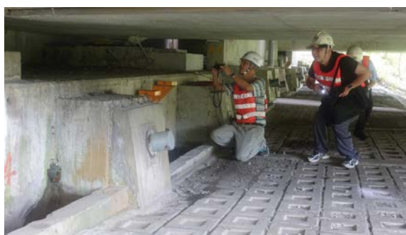
105年陳正興教授(左一)參訪國道3號田寮3號高架橋A1橋台支承因龍船斷層變形所產生的水平擠壓位移
