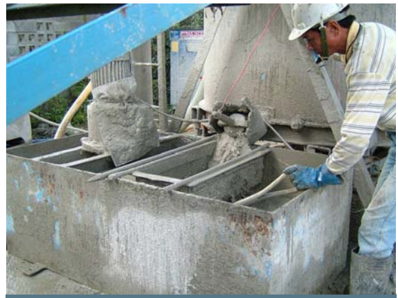
照片8 水泥漿攪拌槽及濾網
