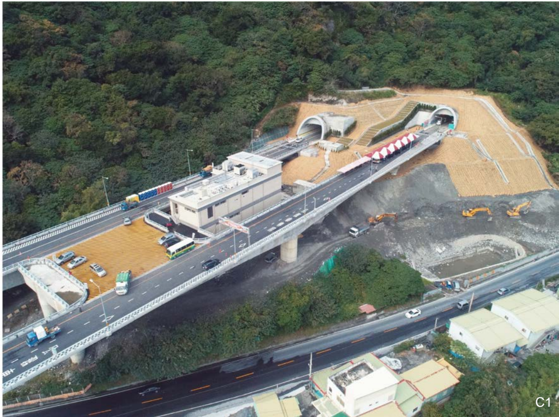
C1 谷風隧道南口防落石延伸隧道、機房、迴車道及路堤，與下方漢本遺址共存
