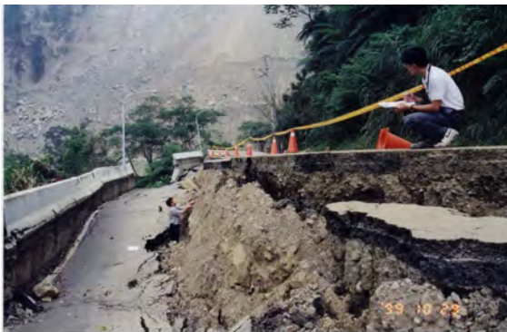
照片二 破壞之邊坡上公路路堤擋土牆(site 2)
