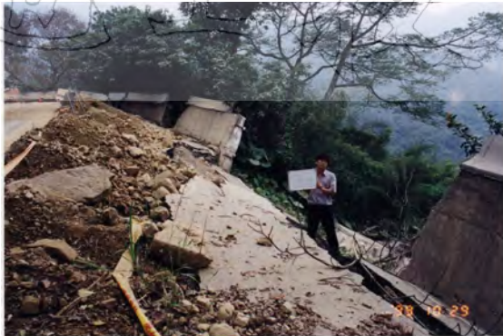
照片一 破壞之邊坡上公路路堤擋土牆(site 1)
