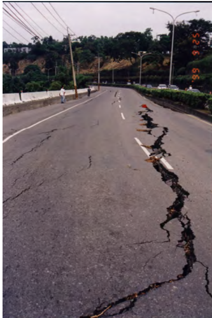
照片三 路面嚴重下陷、龜裂之公路
