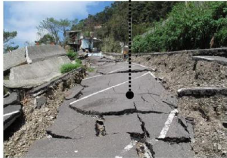
圖十二 莫拉克颱風後藤枝地區之崩滑破壞情形
